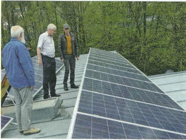
Solaranlage auf dem Dach der Vereinsgaststätte des TSV Alemannia Freiburg-Zähringen
