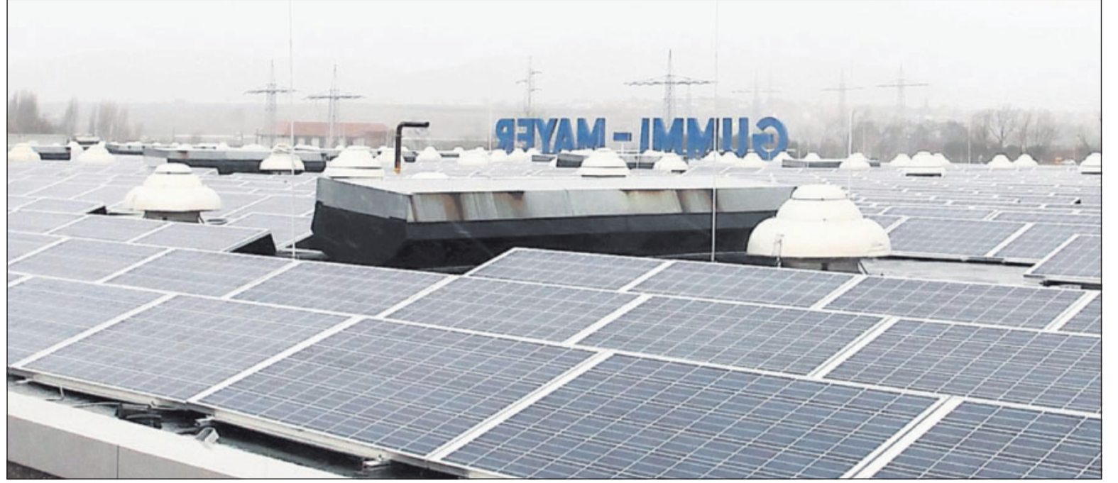
Auf dem Dach der Reifenlagerhalle der Spedition Barth auf dem Gummi-Mayer-Areal arbeitet die drittgrößte Solaranlage Landaus. Nachhaltige Energieerzeugung ist das Credo der Bürger-Genossenschaft, an der auch die GM Projektverwaltung Anteile hält. FOTO: VAN
